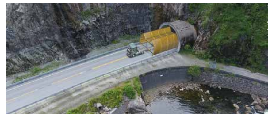
Bilde 2: Den første modulen på mellom 12 og 20 meter kommer på plass der en semitrailer benyttes for transporten.
