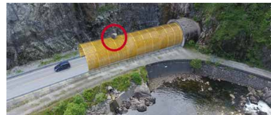
Bilde 4: Den midlertidige tunnelen er ferdig. Faren for at stein treffer veibanen med stor kraft er borte.
